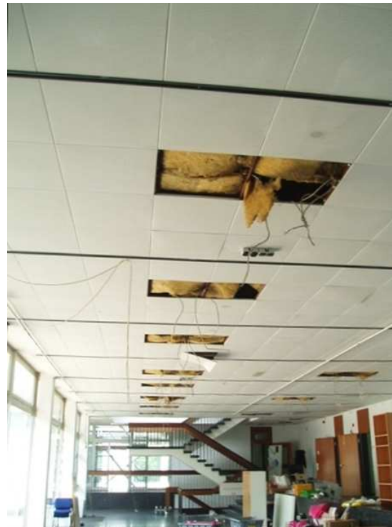
KMF-Dämmung unter der abgehängten Decke des Foyers
