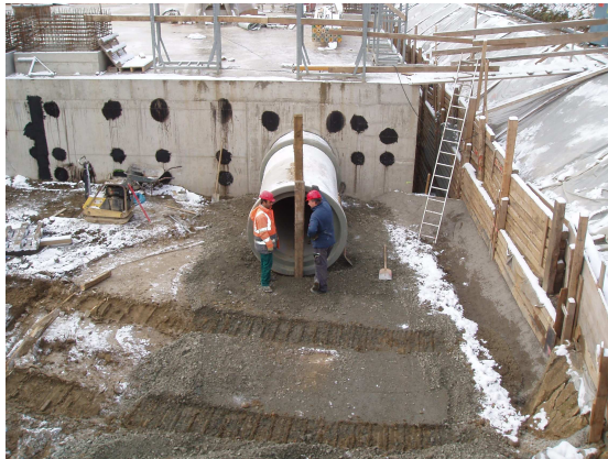
Anschluss an das Regenrückhaltebecken
