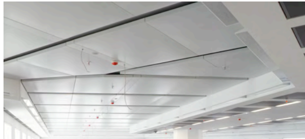
Heiz-/Kühldecken mit Graphit-Elementen im verkleideten Zustand
